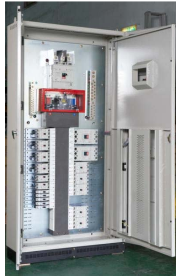
盤體內部結構照
